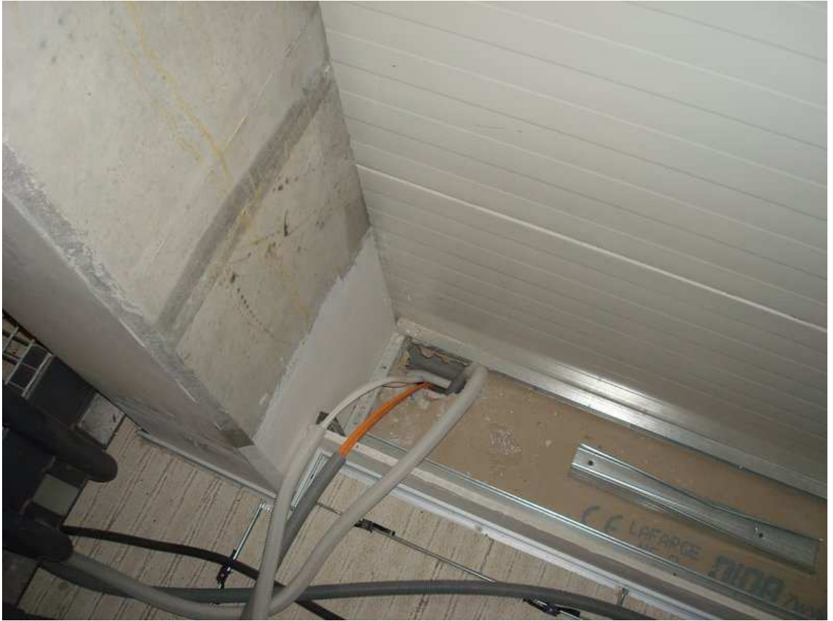
Fot. 1 (uszkodzenie płyty stropowej)
