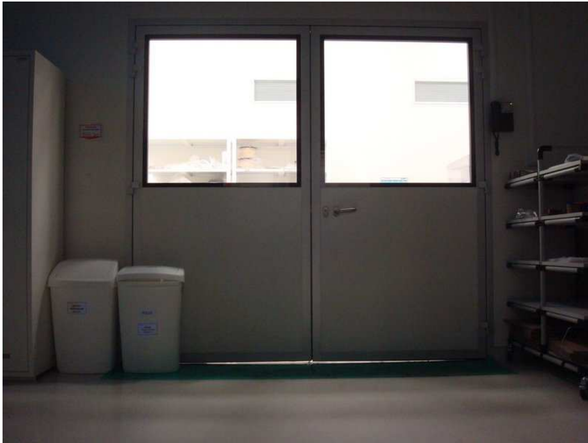
Fot. 3 (nieszczelność drzwi pomiędzy częściami brudną i czystą w służbie towarowej)
